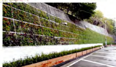
▲ 2009년 늦가을 시공 직후의 남산호텔 벽면모습
